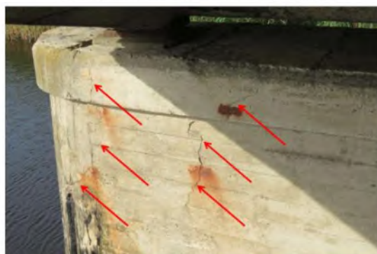
Вертикальные и наклонные силовые трещины по элементам опоры №4 в зоне ниши подвижных опорных частей с максимальной шириной раскрытия до 5,0 мм
