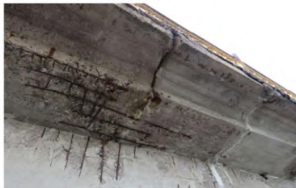
Размораживания и разрушение бетона, отслоение защитного слоя, в т.ч. с оголением и коррозией арматуры балки №1 пролетного строения №2
