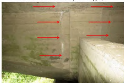
Силовые трещины по плите и ребру балки №2 пролетных строения №4 в надопорной зоне в результате возникающего отрицательного момента, с максимальной шириной раскрытия до 1,0 мм
