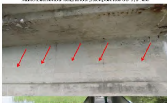
Коррозионные трещины по ребру балки №2 пролетного строения №2 с максимальной шириной раскрытия до 1,0 мм
