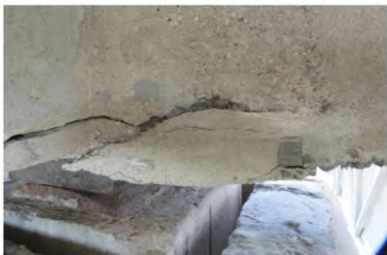
Разрушение зоны опирания балки №2 пролетного строения №3 низовой стороны на опоре №4
